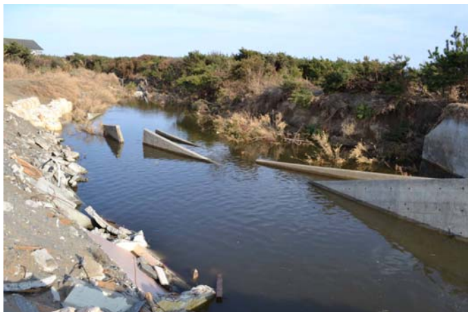
9 小河川の河口付近の護岸被害
