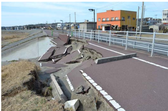
3 飯岡海岸付近の津波被害 津波は堤防護岸も破壊した。
