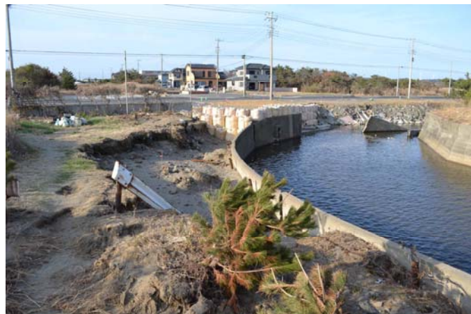
10 小河川の河口の護岸被害
