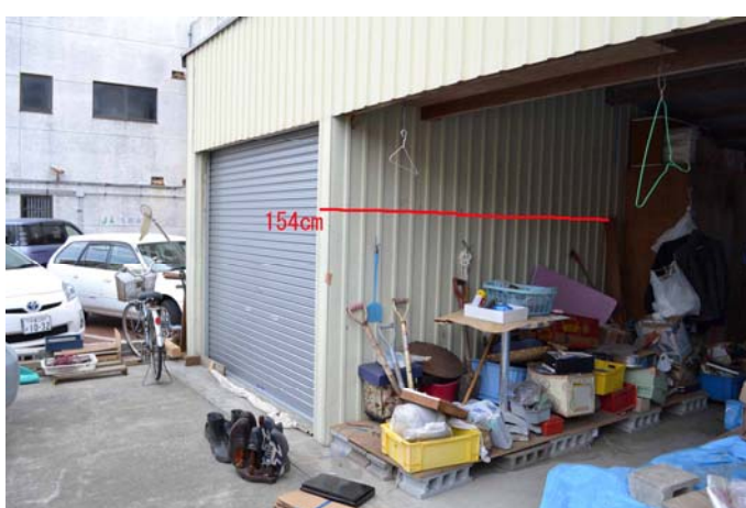
6 飯岡海岸付近の住宅地の被害 波打際から200m内陸の住宅(標高3.7m)では154cmの高さまで海水に浸かった。
