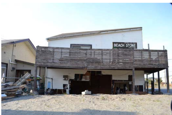
8 九十九里ビーチライン沿いのサーフショップの被害 道路に面する1階部分は津波によって大きな被害を受けた。
