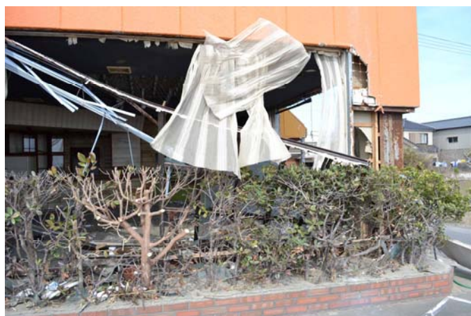
4 飯岡海岸付近のビルの1階の被害 海岸付近のビルの1階は完全に破壊された。
